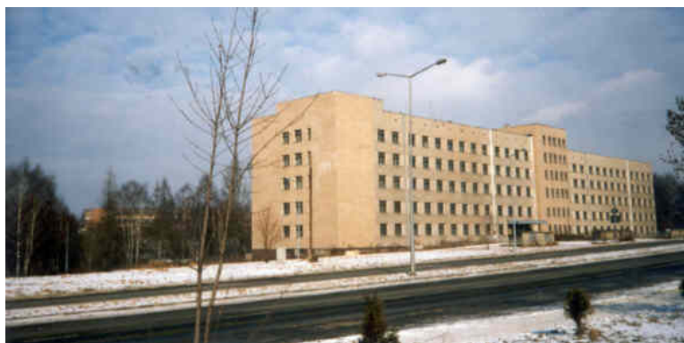
Jastrzebie Zdrój. Niedokonczony, a dzisiaj nie potrzebny Szpital Ginekologiczno-Położniczy w oczekiwaniu na wyburzenie? - fotos I/1998 - EB
